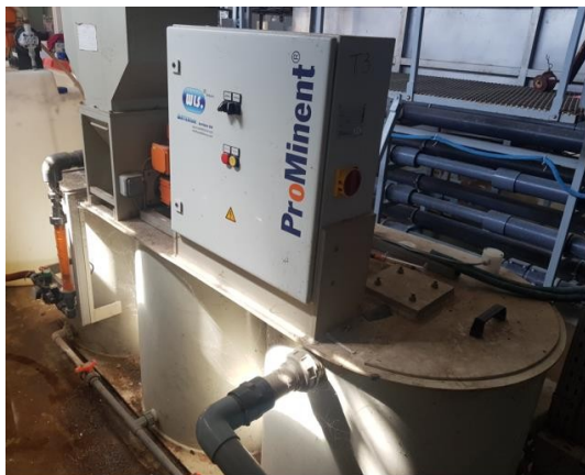
Фото 6. Установка приготовления и дозирования флокулянта
