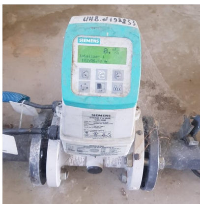
Фото 11. Расходомер очищенной воды
