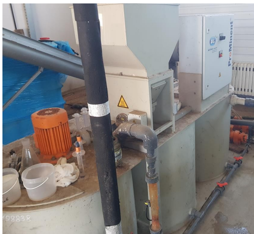
Фото 14. Установка приготовления и дозирования флокулянта для обезвоживания
